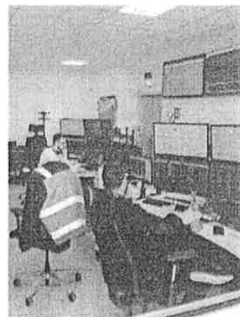
TAP La sala comando del gasdotto
