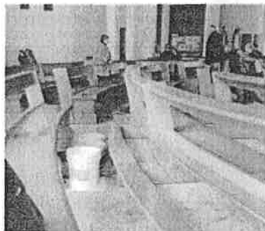
SAN PAOLO | secchi all'interno della chiesa
