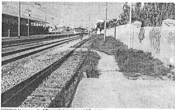
FERROVIA La zona oggetto della segnalazione nei pressi della stazione
