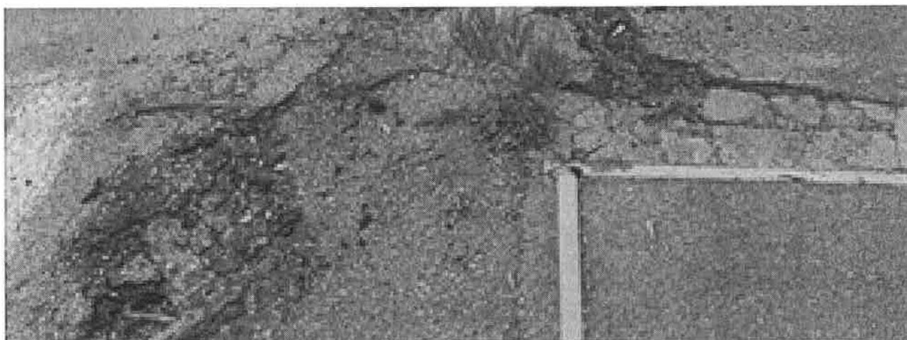
l'asfalto divelto dalle radici degli alberi © n.c.
