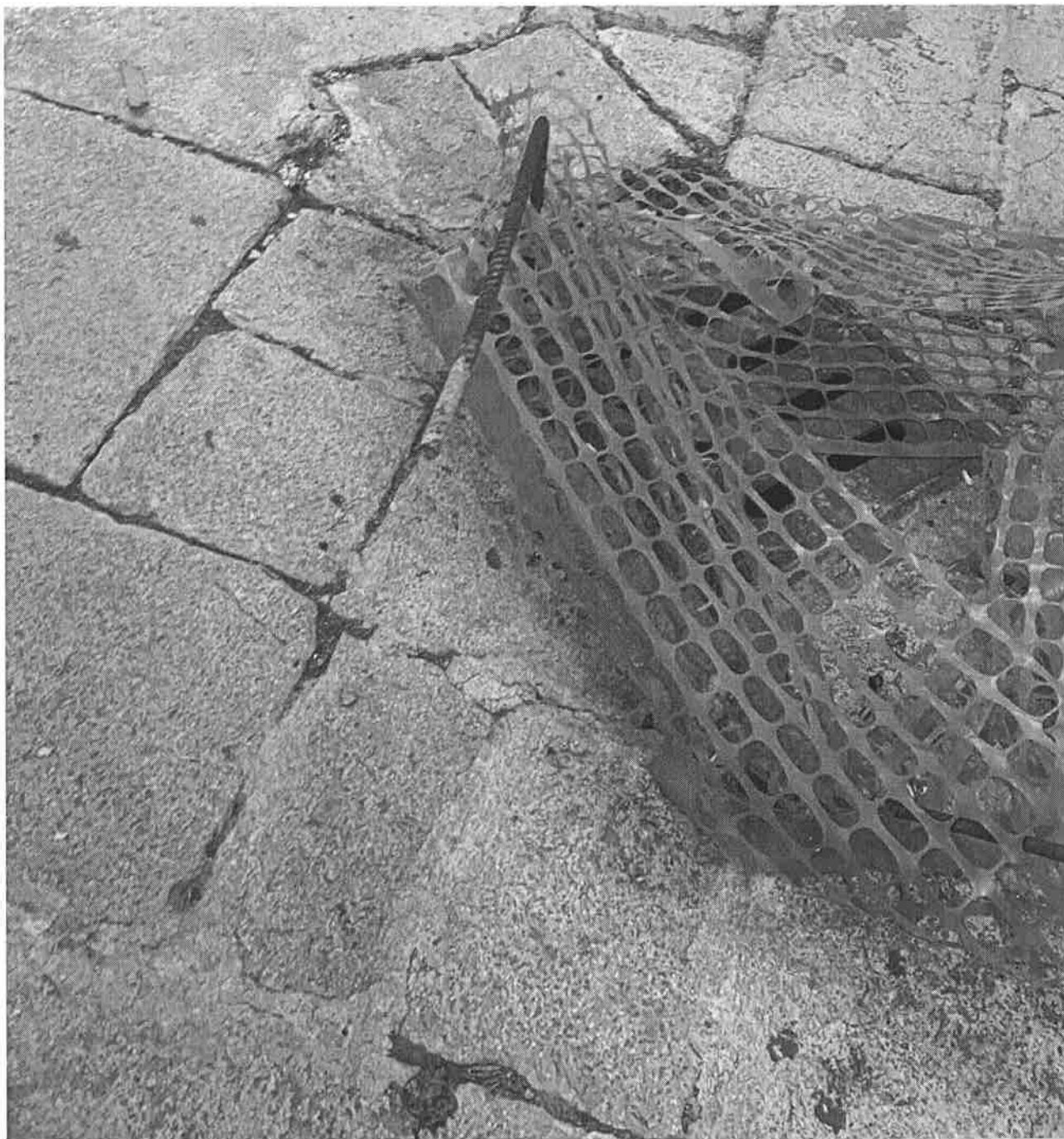
Pericolo a causa della protezione divelta su un tombino in via Quarti © AndriaLive
